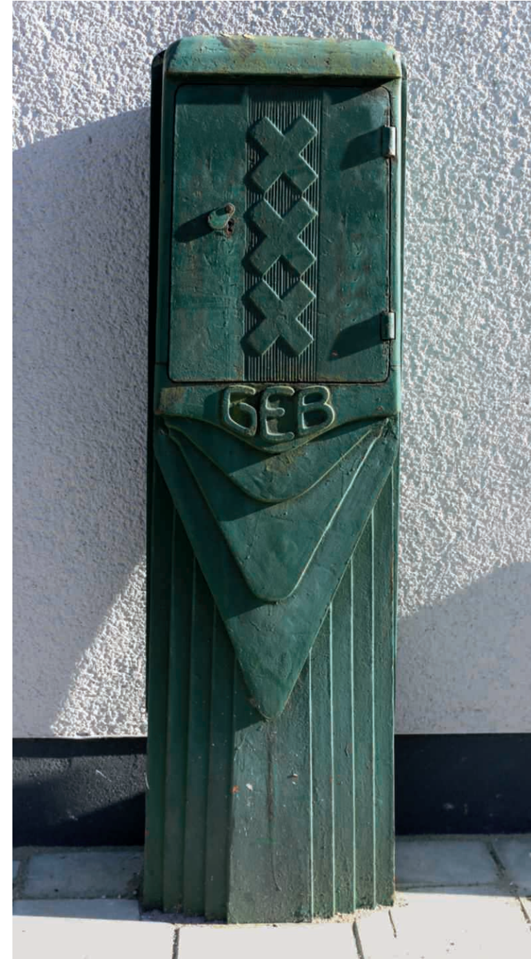
KABELKAST GEMEENTE-ELECTRICITEITSWERKEN MODEL G ZAAIERSWEG, BETONDORP PIETER MARNETTE 1928
